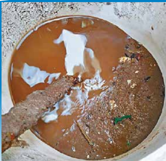
有大廈水箱多年沒有清洗，積聚大量汙泥。
