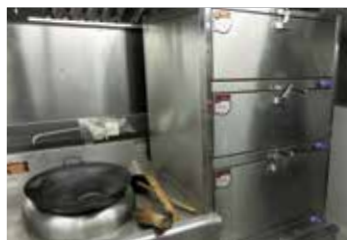
中式鑊及蒸爐。
