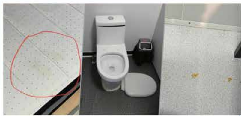
新田方艙醫院有房間出現大量糞漬，廁所設施損毀。
